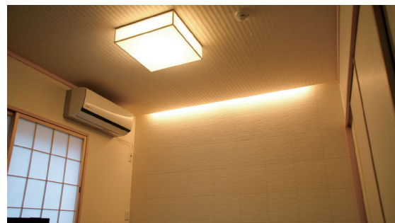
和室には、壁面を照らす間接照明を設置。
